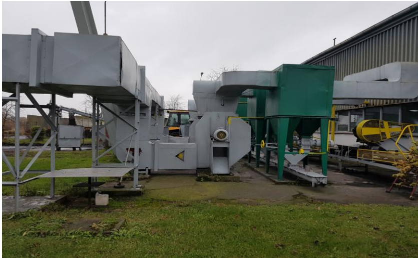
Rys.1. Widok instalacji odpylania kotła nr 2.
